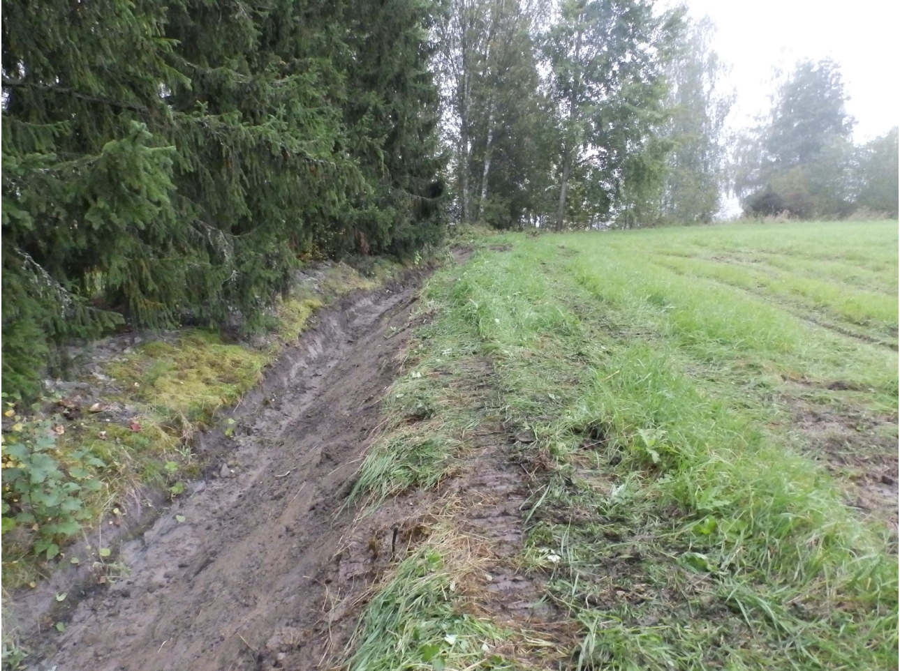
Kuva 9. Perattu oja työskentelyn päätyttyä. Kuvassa vasemmalla näkyy aikaisemman kaivamisen yhteydessä ojan pientareelle sammalen päälle nostettua savimaata. Puiden takana Kokemäenjoki. Kuvattu kohti etelää. Kuva: Ulla Moilanen (KYY 142:9).
