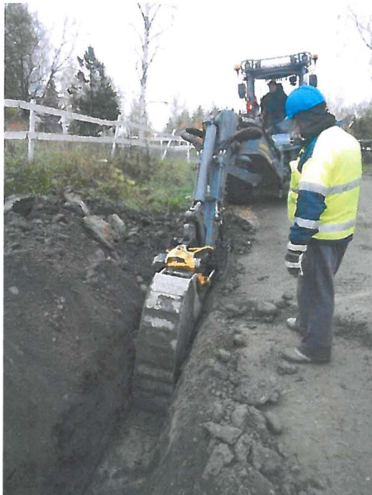
Kuva 1. Tiensuuntaisen kaapeliuran kaivuuta Suomatkan kylätontin lounaispuolella. Kuvattu luoteesta. (Kuva: Kangasala Huutijärvi – Pispala 2014: 1)
