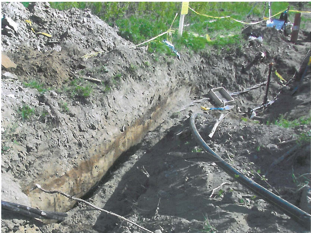
Kuva 2. Kaivannon länsireuna kuvattuna pohjoisesta. Yläkulmassa kaasujohdosta kertova valkoinen tolppa. Entisen peltokerroksen päällä on hieman vajaa puolimetriä sekoittunutta täyttömaata (harmaa).
