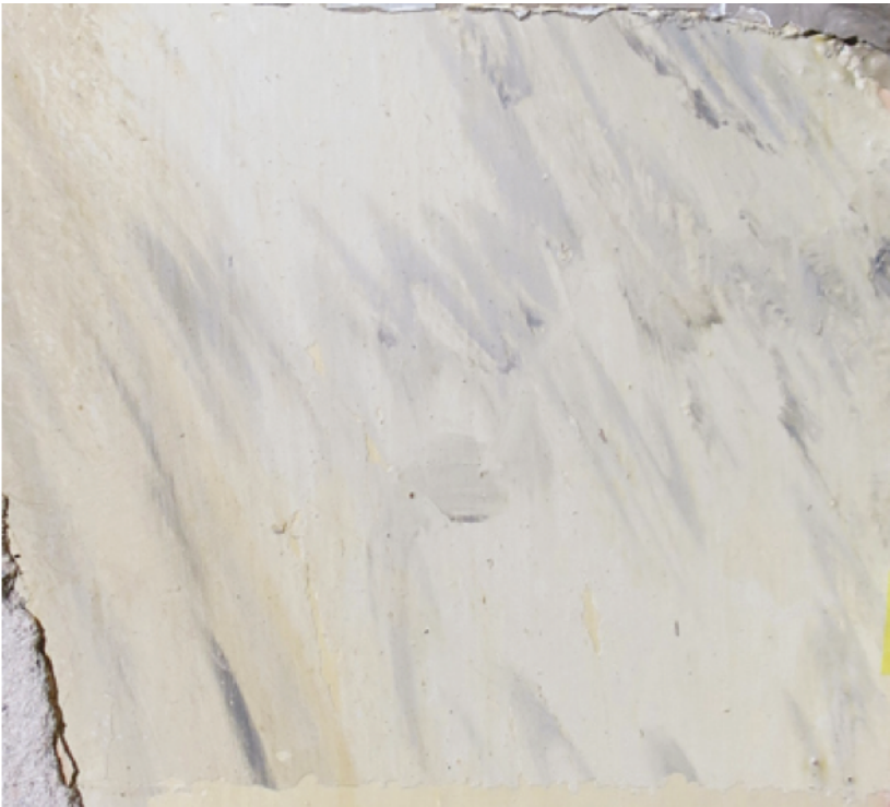
Lähikuva seinän alapanelin marmoroinnista. Pohjasävy vaalean harmaa 1505-G80Y, suonistuksen vahvuus vaihtelee mutta keskimäärin 3005-G80Y.
