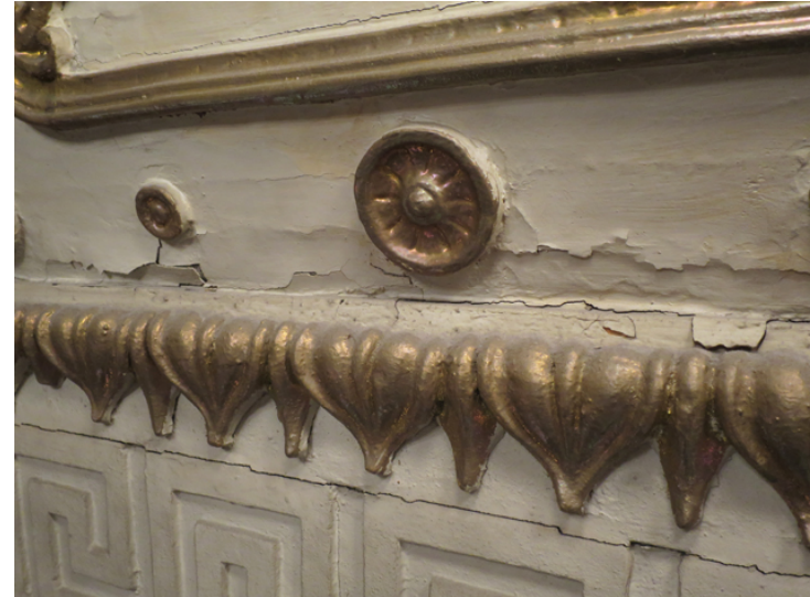
2. parvikaiteen alareunaa. Maalit hilseilevät paksuina kerroksina ja laajasti. Kunnostustyössä joudutaan pohtimaan onko irtoilevia kerroksia mahdollista kiinnittää vai onko niiden poistaminen ainoa vaihtoehto.
