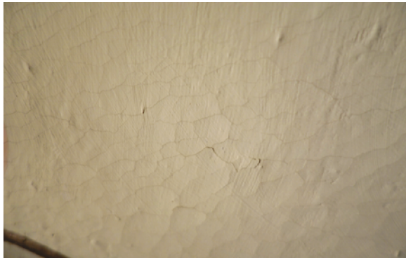
Laajalla alueella maalipintojen krakelyyriä.
