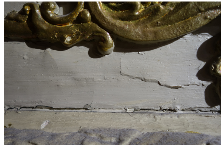
1. parvikaiteen maali-irtoamaa. Osa irtonaisista maalikerroksista ovat "pussilla" eli irti pohjastaan, mutta vielä toistaiseksi ilman näkyvää halkeamaa.
