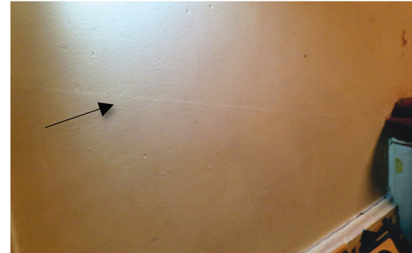
Sivuväli paljastaa parviseinällä olevan alapanelin rajan (nuoli). Paneli oli pilarissa 700mm korkeudella, mutta laski viistosti parvikaiteeseen.
