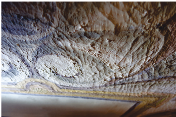
Kuvassa voimakasta krakelyyriä ja osittaista maalihilseilyä.
