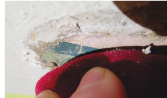
Parvikaiteen kankaan juuresta paljastui seinäpinnan koskemattonta ja alkuperäistä 1879 maalaus pintaa.
