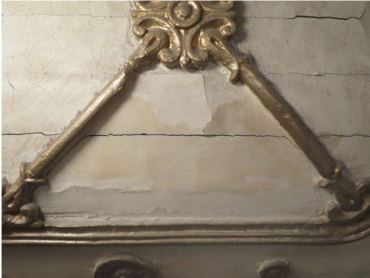
Kuva 2. parvikaiteesta. Kuvan keskellä erotettavassa maalipinnassa värjäymää, joka vaikuttaa nousseen pohjasta päin. Värjäymää näytti olevan paikoitellen kautta koko kaiteiden.
