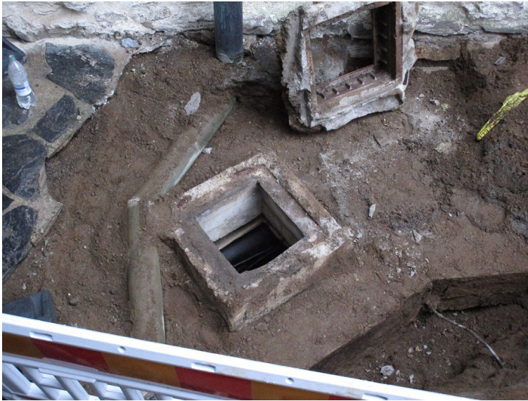
KUVA 3. Kanavan sisäänmeno, josta kansirakenne on poistettu. Kuvassa näkyy myös putki, joka johtaa sadevedet syöksytorvesta kaivoon. Kuva: Tuija Väli-Torala, Kivityö Kaseva Oy.
