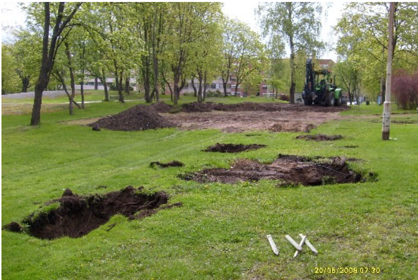
Kuva 12: Eteläpuistokadun vanhaa linjausta ja sen alueelle kaivettu istutuskuopparyhmä VII. Istutuskuopparyhmä VIII sijaitsee kuvassa näkyvän kaivinkoneen takana. Keskellä kuvaa vanha leikkikenttä. NW. Kuva KyM/M. Kykyri.
