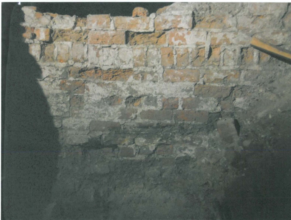
Kuva 4. Musta palorantu kellarin väliseinän alaosassa koilliseen. I. Aalto. DG2925:87
