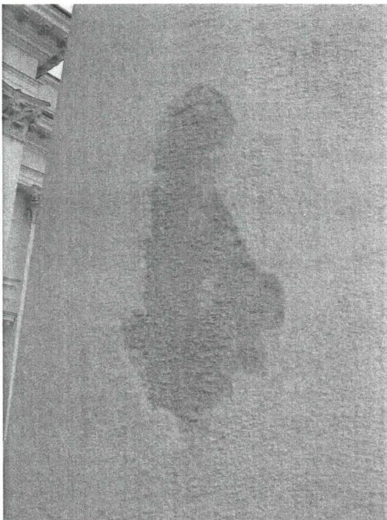
Kuva 4: Pylväissä esiintyi kuvan mukaisia pintarappauksenvaurioita.
