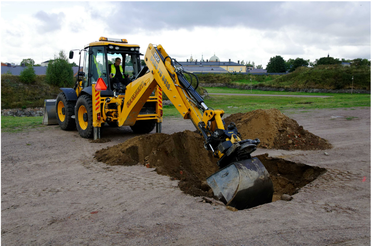
Kuva 3. Kaivaminen aloitettiin alueen luoteiskulmasta. Kuvan oikeassa reunassa erottuva punainen maaliviiva merkitsee kaapelin paikkaa. Pihan täyttö- ja tasoituskerrokset koostuivat yksinomaan hiekasta ja kivistä, seassa oli jonkin verran tiilenpaloja.
