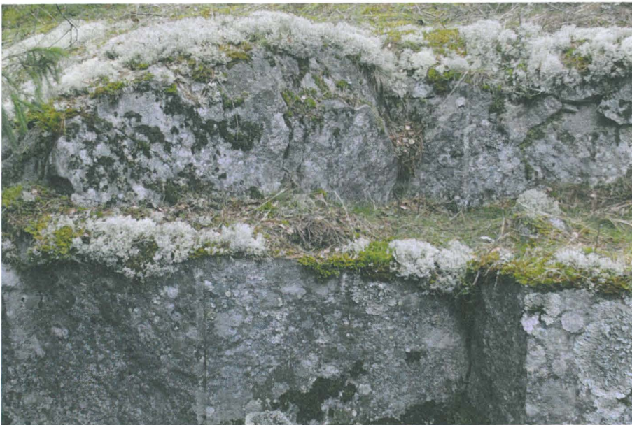
Porausjälkiä kahdessa tasossa.
