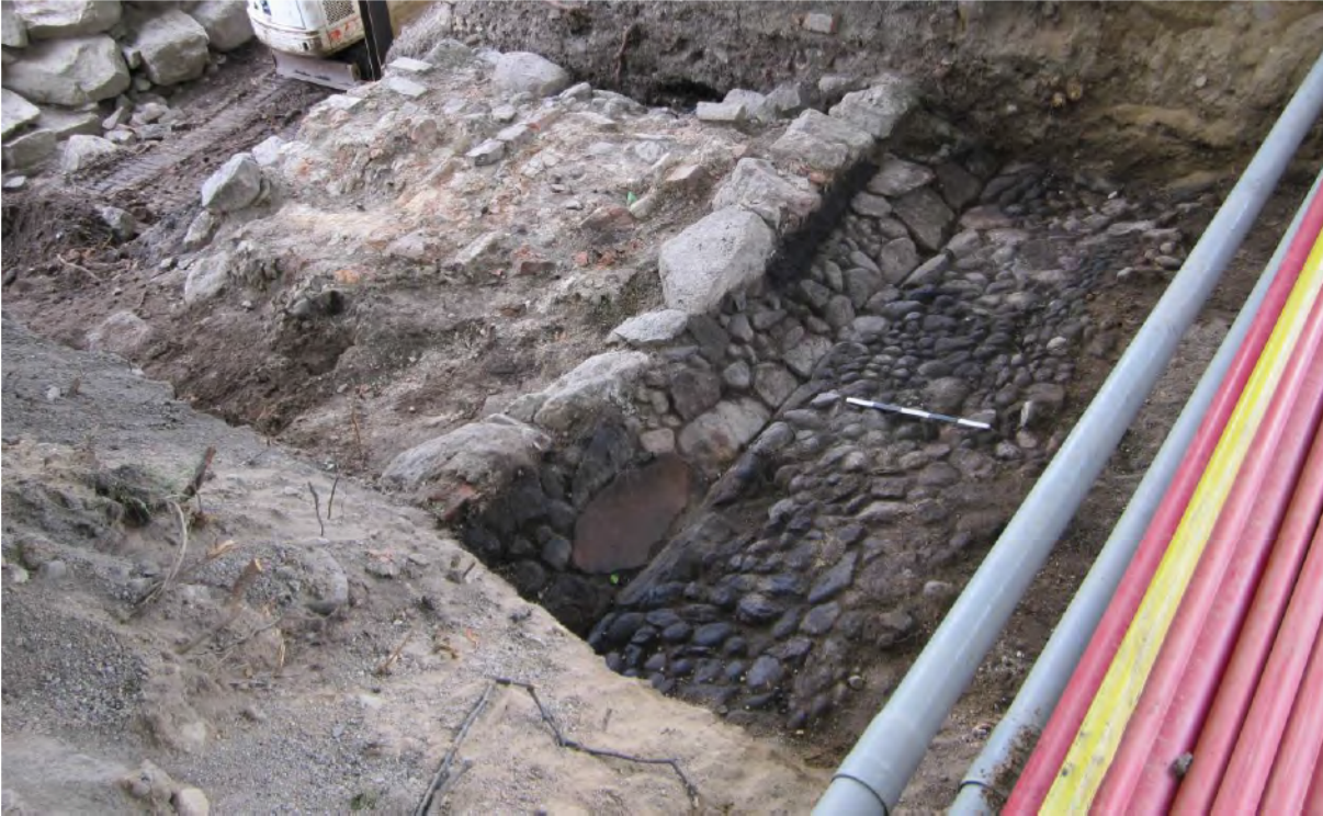
Kuva 11. DT2013_15_066: Kiveys R026 ja perustus R022. Perustuksen alta tulossa esiin tulisijanjäännös R018. Kuvattu etelästä. Kuvaaja Virva Lompolo.
