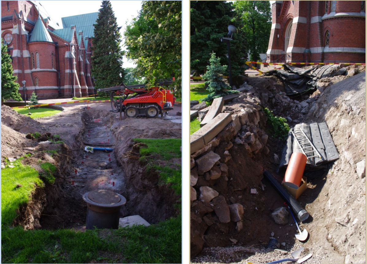
Kuvat 11-12: Vasemmalla alueen VA NE-pään kalliopintaa panostettuna ennen räjäytystöitä. NE. Oikealla saman alueen SW-päätä kallion räjäytyksen jälkeen ennen viemäriputkien ja kaivojen asentamista. N. Kuvat: KyM/M. Kykyri.
