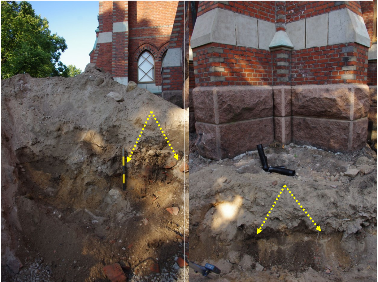
Kuvat 66-67: Vasemmalla viemärikaivannon poikkileikkaus kirkon SE-sivustalla. Kellertävännruskean steriilin pohjamaan päällä, mittatikun oikealla puolella, näkyy oranssinpunaista tiilijätettä sisältävää, kirkon rakentamiseen liittyvää kerrosta. NE. Oikealla kirkon Kirkkokadun puoleisen sivuportaalin vieressä säilynyt, hiilen mustanruskeaksi värjäämä patkä Ruotsinsalmen aikaista kulttuurikerrosta. E. Kuvat: KyM/M. Kykyri.
