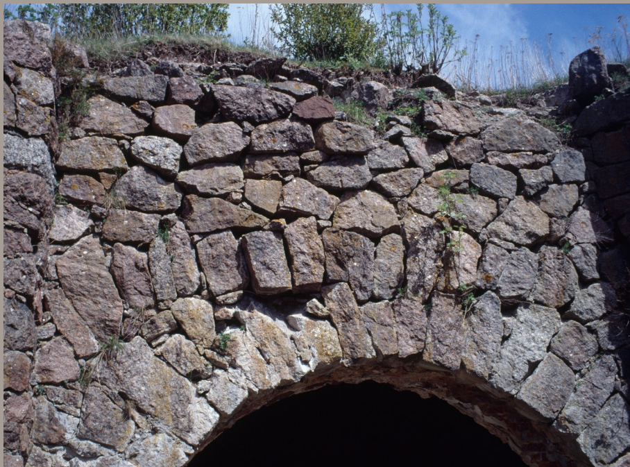
Bastioni Schantzin bastionipihan muuria 1990-luvun alussa. Sade- ja sulamisvedet ovat valuessaan muurin yläpuolella olevalta tykkitasanteelta liuottaneet muurauslaastissa olevan kalkin. Saumassa kasvavat kasvit ovat merkinä ylimääräisestä kosteudesta, ulostyöntyneet kivet holvin päällä jäätyvän veden aiheuttamasta vaakaroutimisesta.
