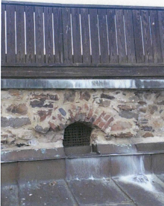
Kuva 7 alapuolinen aukko joka suljettiin sisäpuolelta Valokuva Antti Haikala
