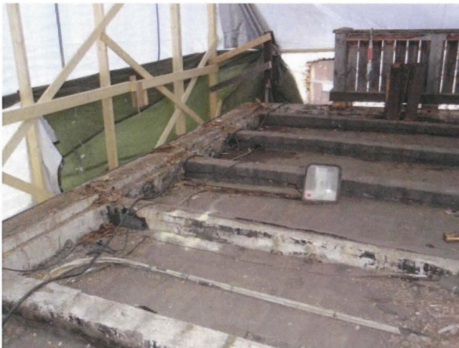
Kuva 2 Kannen päällä 70- luvun betonikorokkeet sekä vanha bitumihuopa Valokuva Terho Kaskinen
