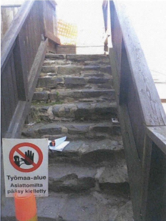
Kuva 8 kiviporras ennen korjausta Valokuva AH
