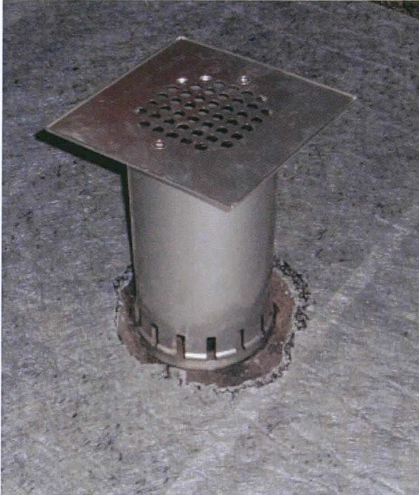
Kuva 3 Sadevesikaivo sekä salaojamatto Valokuva TK
