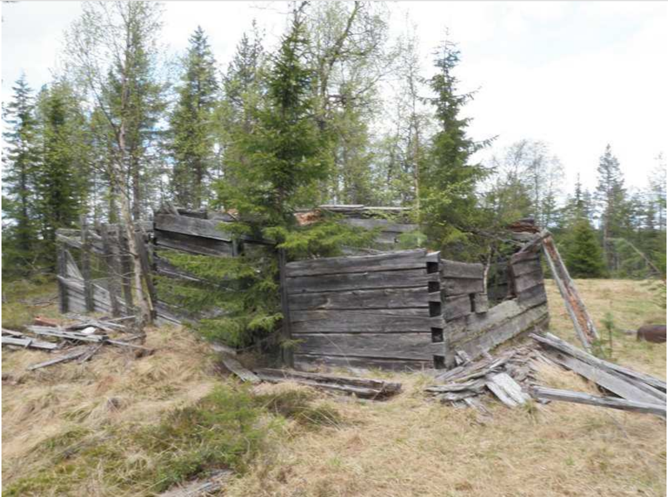
Rakennuksen 1 nurkissa on tiivis lohenpyrstösälvos.
