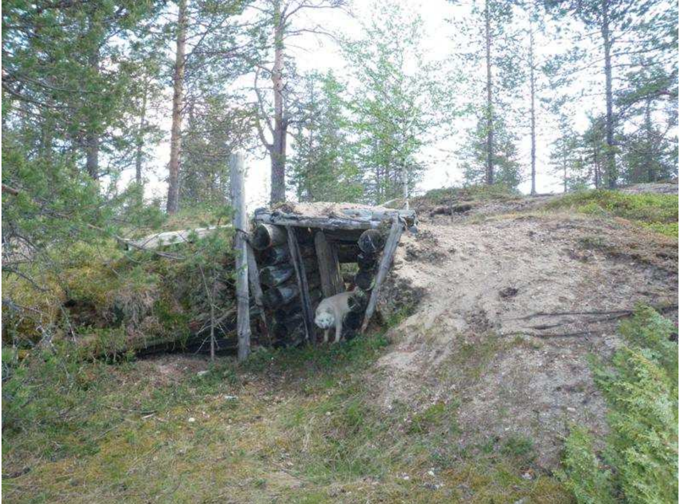
Kohteessa on kaksi samanrakenteista, romahtanutta kellaria.
