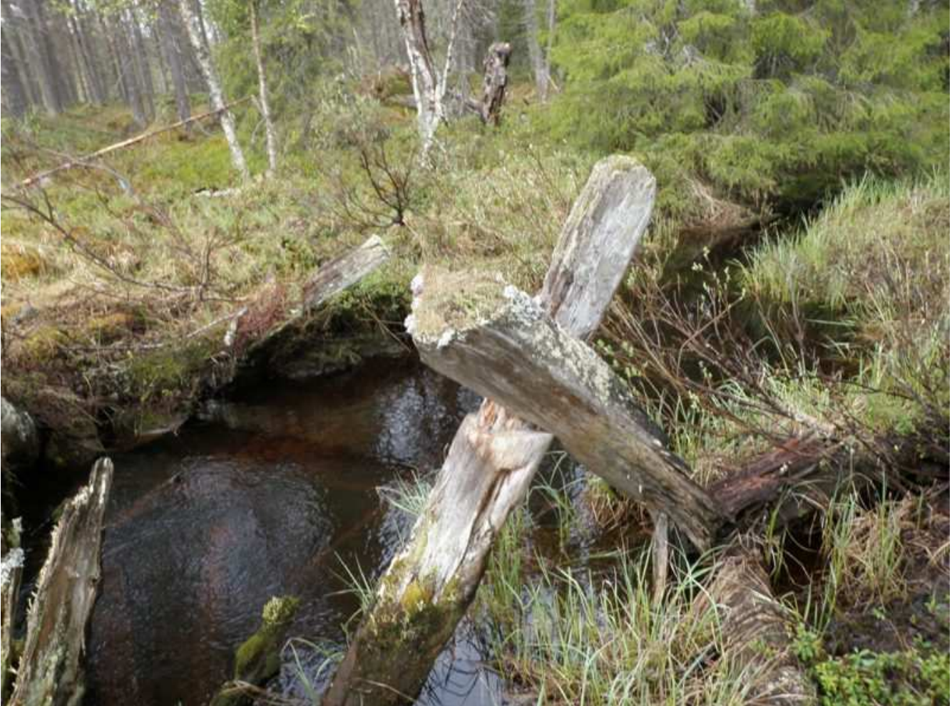
Uittopadon puurakenteita. Padon alavirran puolella on ristikkorakenne, joka on vastustanut veden painetta.
