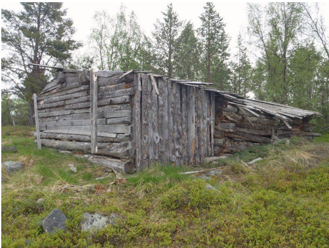
Kuva 79. Porosuojaan seinä on notkahtanut. Etualalla eteinen. Kuvattu länsiluoteesta.
