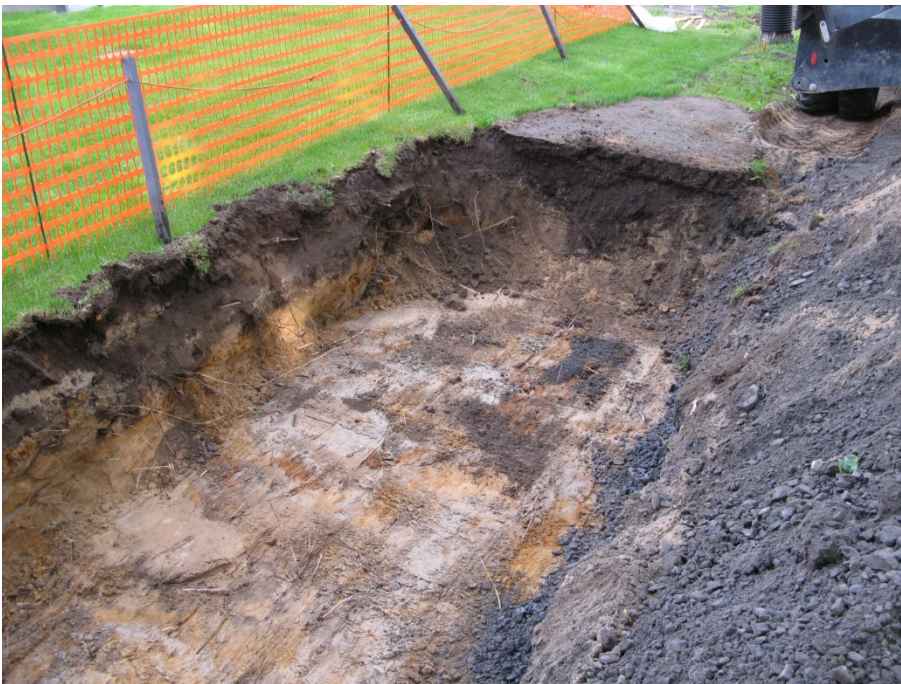
AKDG 4274_22. Toisen penkin alusta, yleiskuva kaivannosta, pohjamaa näkyvissä. Luoteeseen. Kuvaaja: Terhi Tanska.
