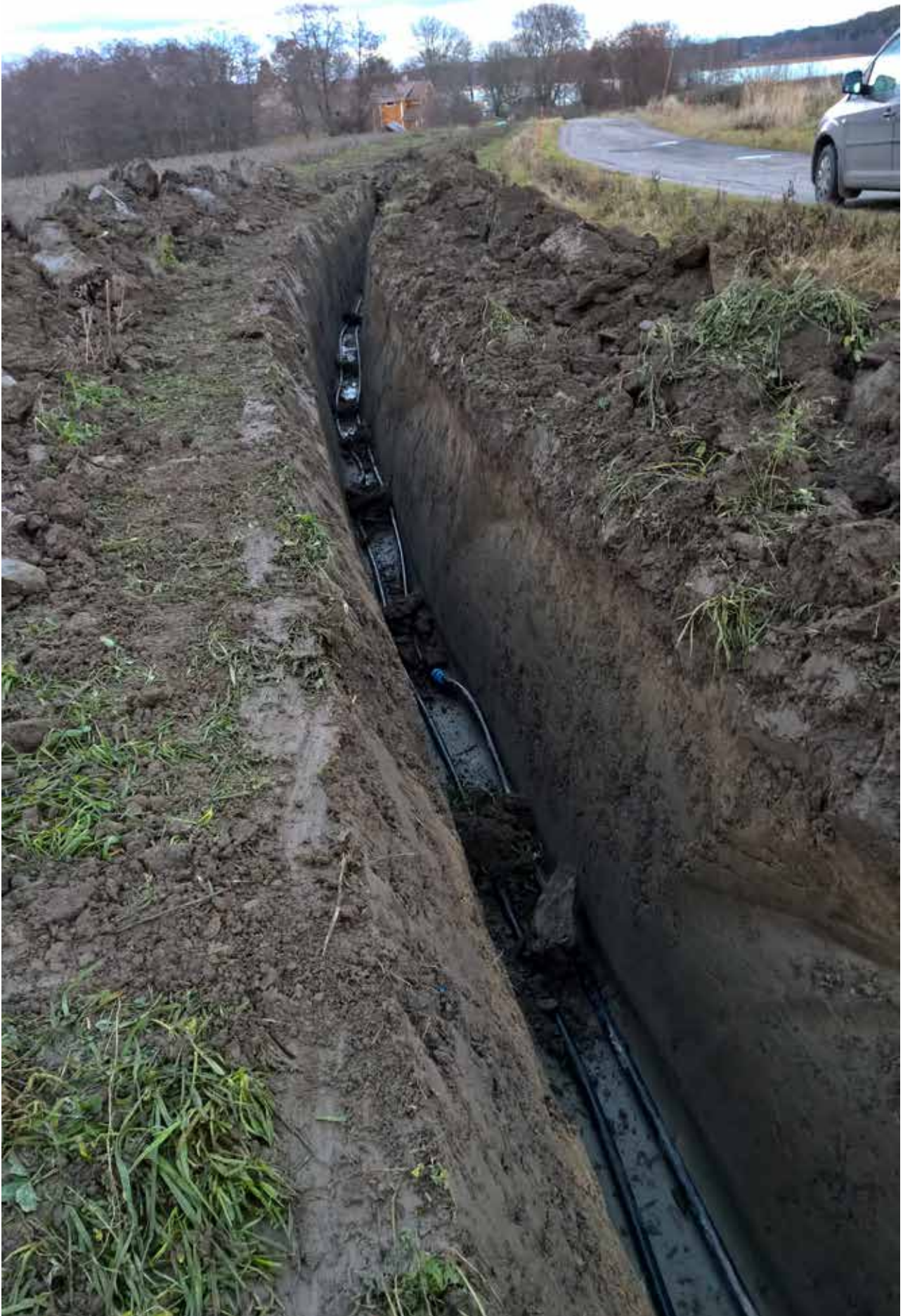
Kuva 5. Putkikaivannon peltoosuus. W. K.Uotila. Marraskuu 2015.
