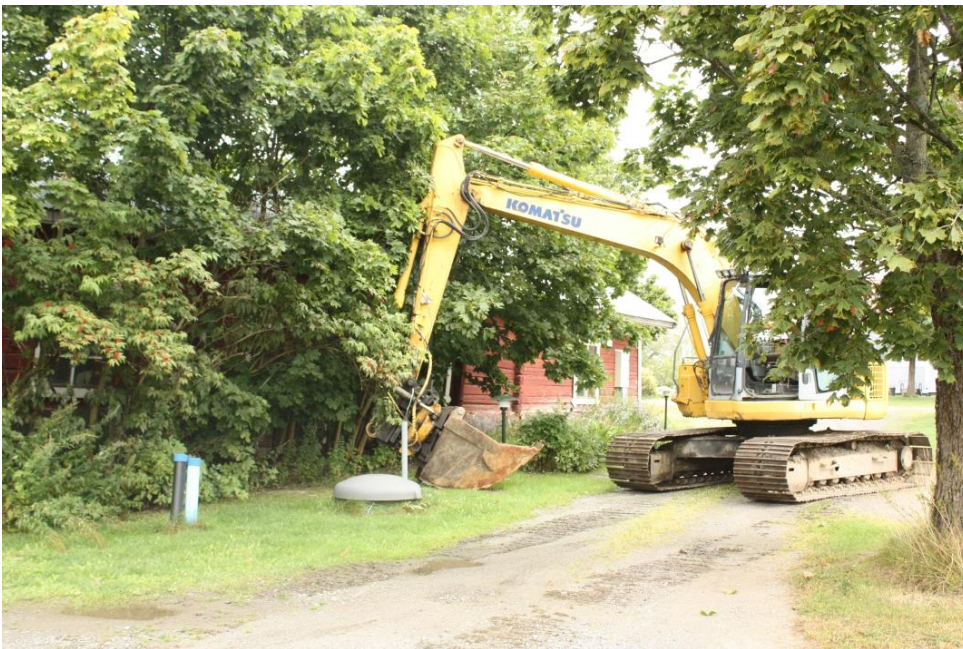
Kuva 6. Jätevesikokoajapumppaamon sijainti Ranta-Alikylän vanhan navetan kaakkoispuolella ennen sen esille kaivamista, kuvattu etelästä. AKDG 4666:8
