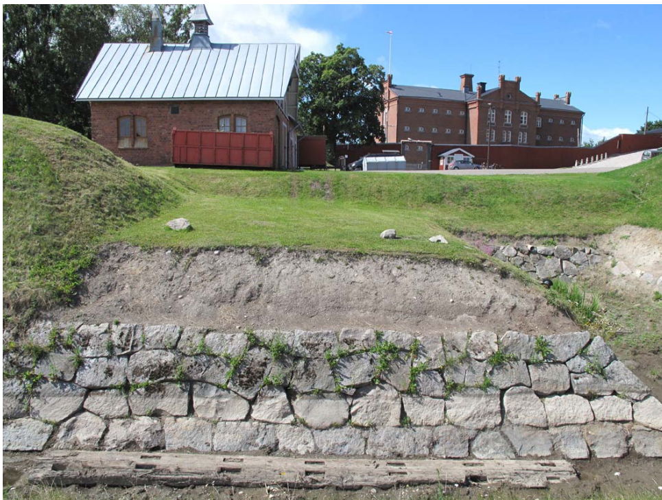
Kuva: Vuonna 2013 paljastui vallihaudan puhdistamisen yhteydessä sillan puurakennetta. AKDG4680:33 Päivi Hakanpää, Museovirasto.
