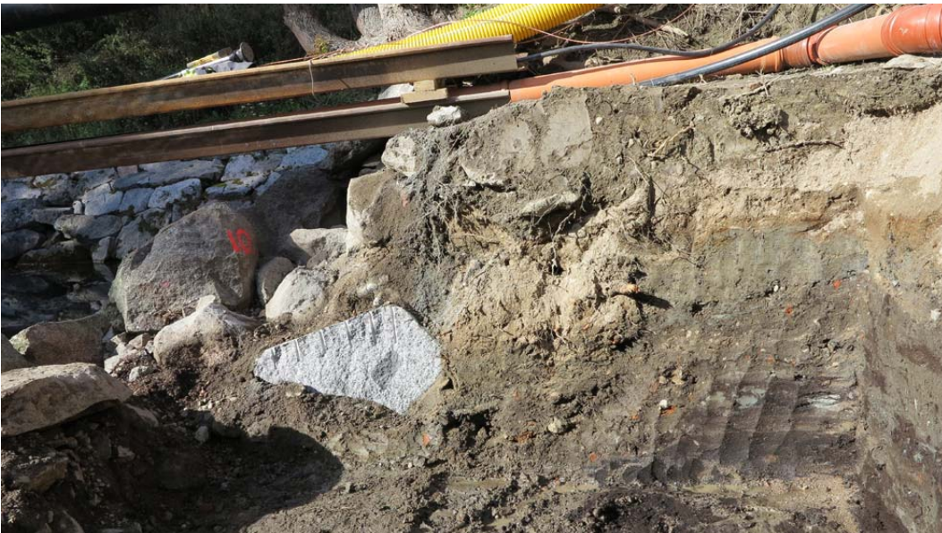
Kuva: Eskarppimuurin luoteisprofiilista jouduttiin halkaisemaan ja poistamaan lisää kiviä, jotta uuden tekniikkasillan perustukset saatiin mahtumaan kaivantoon. AKDG4680:82 Päivi Hakanpää, Museovirasto.
