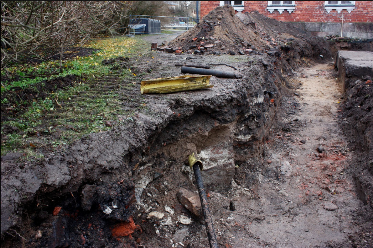
Kuva 6. Sähkökaapelin alapuolella on muurattu kiviperustus, joka saattaa olla 1840-luvulla suunnitellun sairaalarakennuksen perustuksen kulma. Taustalla oikealla saunan pannuhuoneen perustus. Kuvattu luoteesta. AKDG4600:3.
