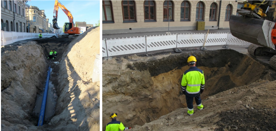
Vasemmallä: Rantakadun ja Pakkahuoneenkadun risteykseen päättynyt vesiputkikaivanto, jonka profiilit olivat molemmin puolin puhdasta pohjamaata SY16. Oikealla: Rantakadun ja Pakkahuoneenkadun risteuksen ostohiekalla täytetty laaja kaivanto. AKDG 4273: 156 ja 154.
