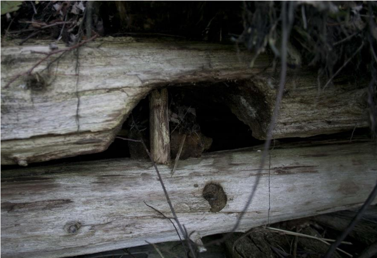
Kuva 28. Hirsiarkun veden yläpuoliset osat rantapenkereessä ovat kuivuneet ja lahonneet. Hirsiä on tapitettu kiinni toisiinsa salvosten kohdilta puutapein. Kuvaussuunta on luoteeseen.
