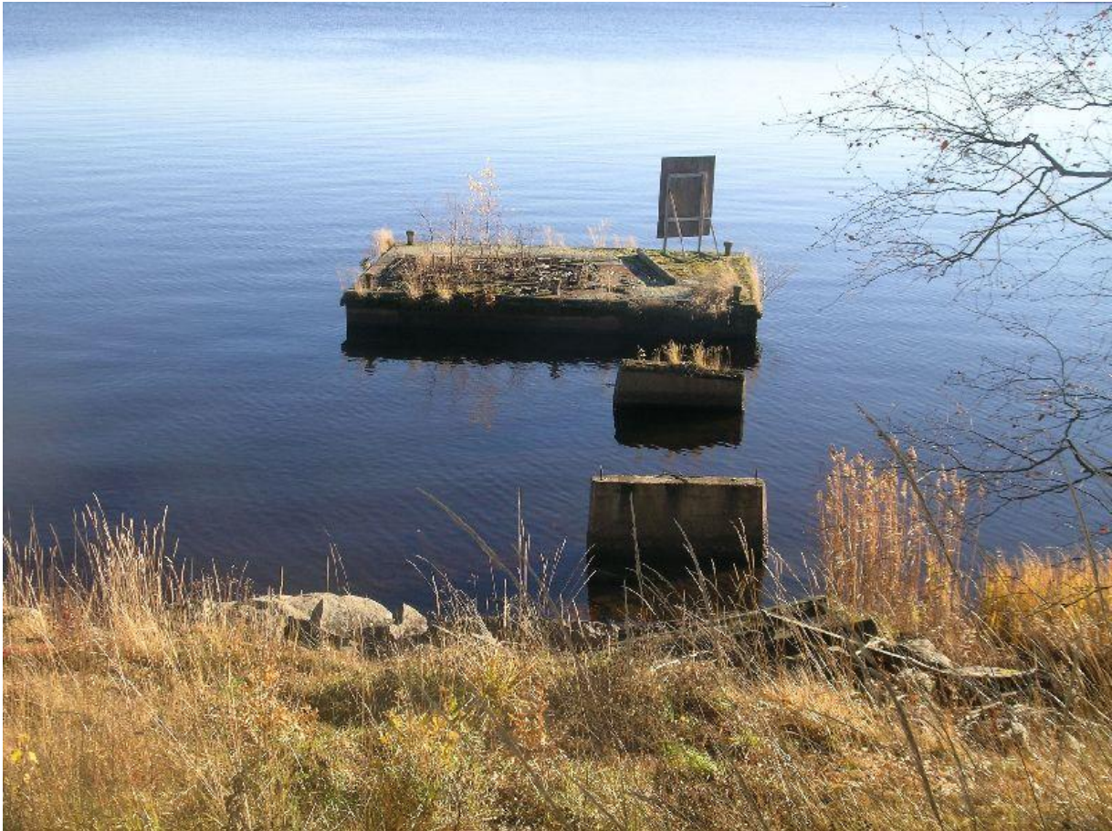
KYY 167 : 34 Betonilaiturin raunio kartanon niemen kärjessä. Lokakuu 2015. Sami Raninen
