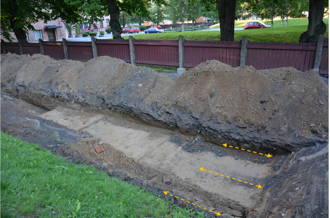
Kuva 10. Kaivantoa valvonta-alueen länsipäässä. Kevyen liikenteen väylän alla puhdasta hiekkamaata leikkasi kaivannon suuntaisena useampi kaapelioija, joiden sijainti on merkitty kuvaan katkoviivoilla. Kuva: Ulla Moilanen (KYY 163: 22).
