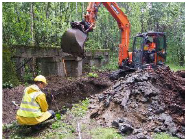
Kuva 15. Koeoja 8 sijoitettiin varikkoon kuluneiden betonirakenteiden eteläpuolelle.
