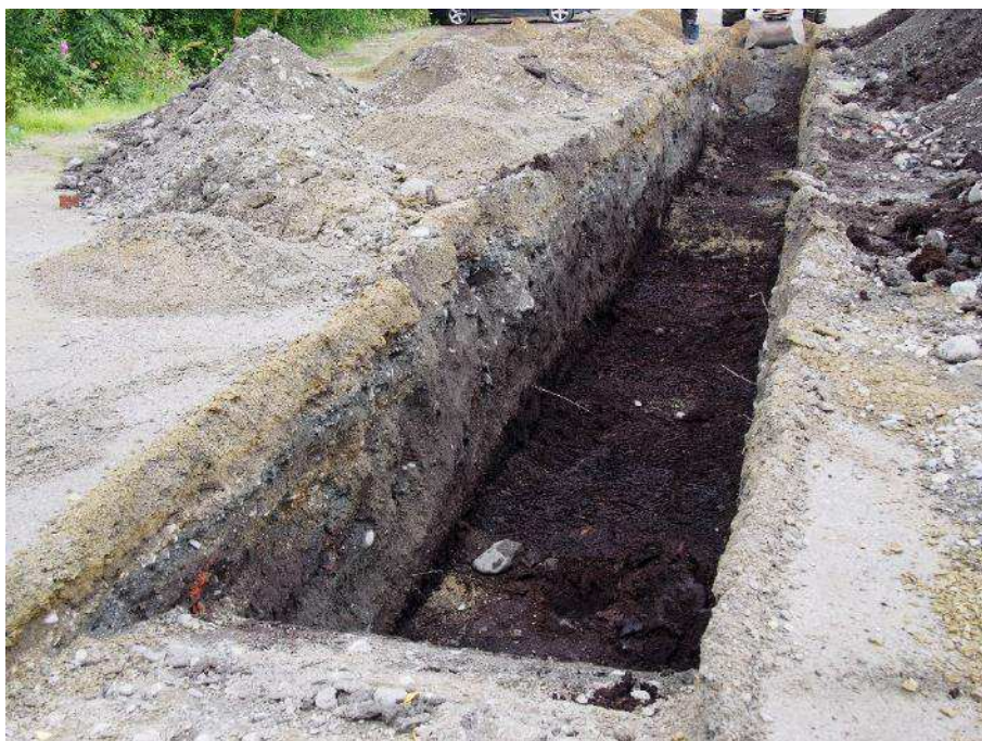
Kuva 5. Koeaja 1:n lounaisosaa (a). Pohjalla ruskea turve. Kuvan yläosassa sekoittuneen maan kaistale. Tälle kohdalle on aiemmin kaivettu vesihuoltolinja.
