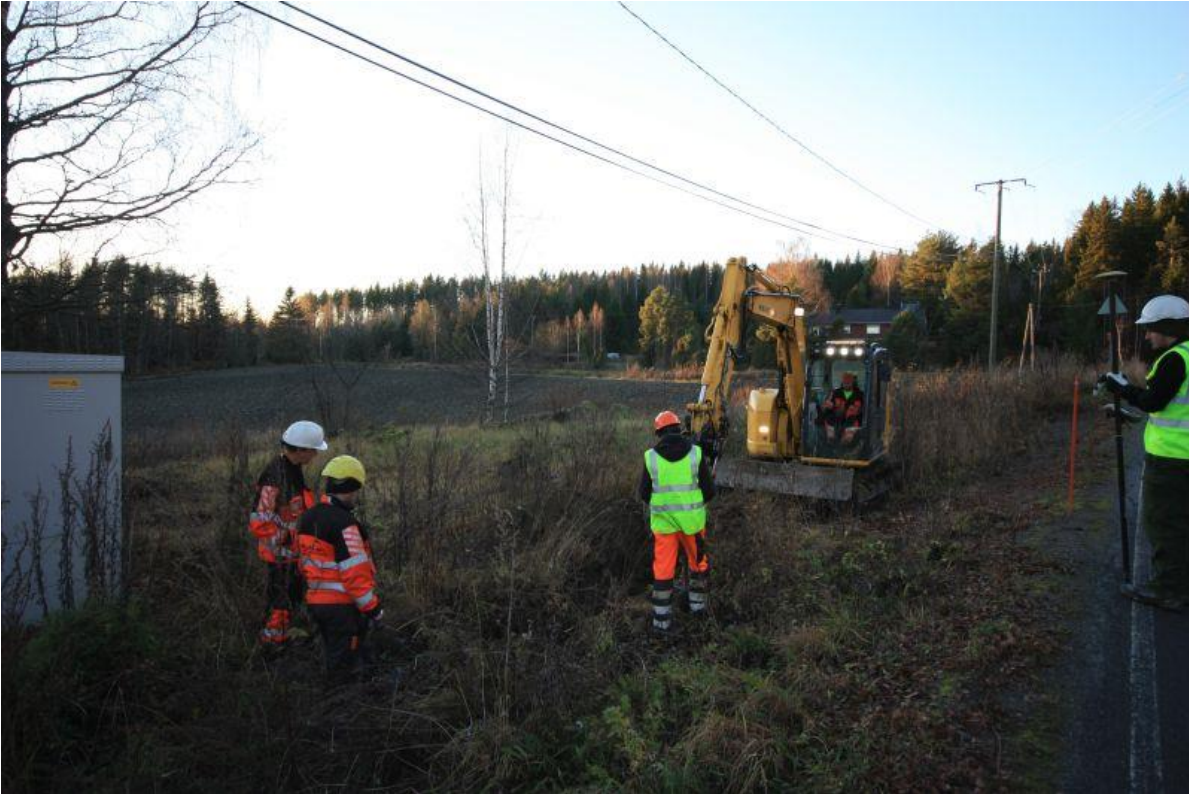
AKDG4667:6. Sähkökaapelin linjan konekaivun valvontaa. Kuvattu kaakosta 4.11.2015. Kuva Esa Mikkola, Arkeologiset kenttäpalvelut
