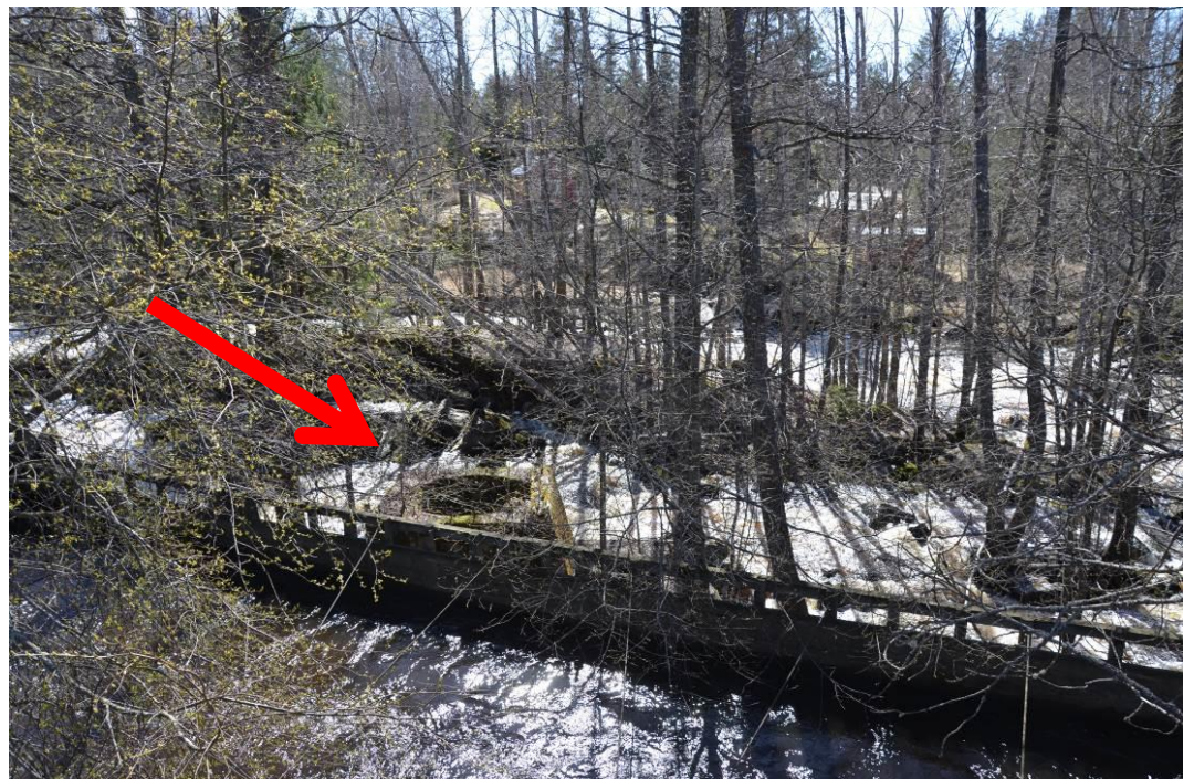
Kuva 18. Kuvan keskellä valettu rakenne, jonka funktio ei inventoinnin yhteydessä selvinnyt. Rakenne on yllä olevan kartan kirjaimen A vieressä.
