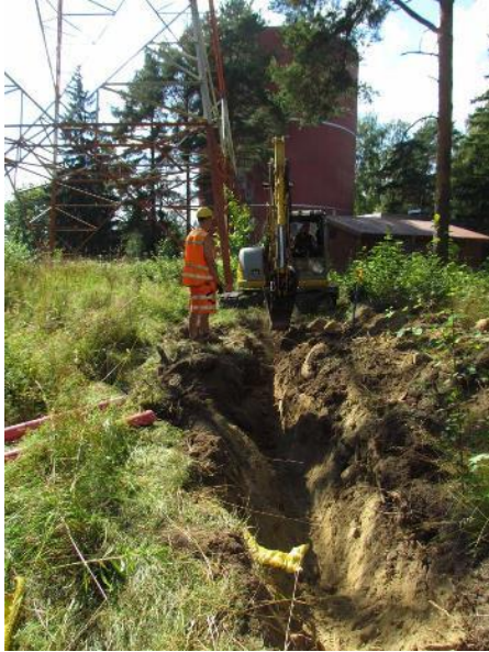
Kuva 4. Maakaapelikaivantoa valvotun linjauksen keskiosassa. Kuvan edustalla näkyy vanhan, paikalle jo ennestään kaivetun kaapelin suoja-putkea. Kuvattu itäkaakosta. (Kuva: Hämeenlinna Imatran Voima 9 2015: 3)
