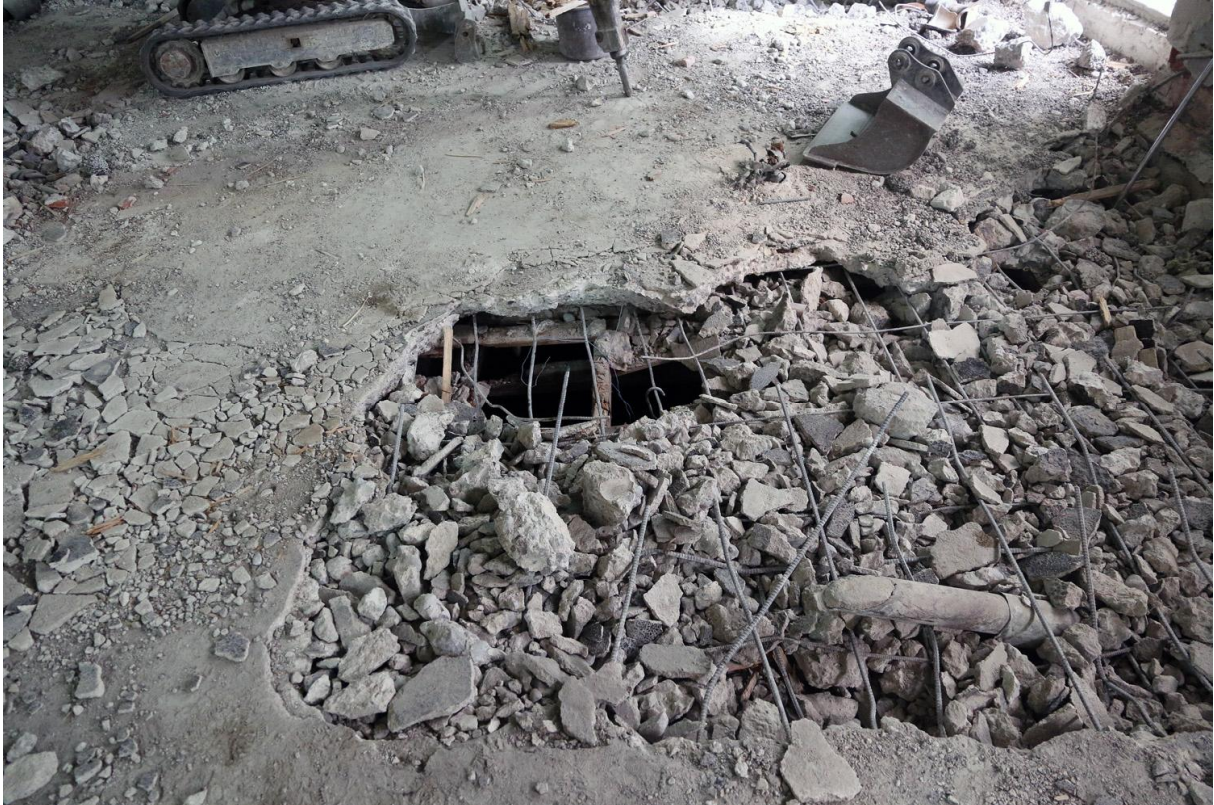
Kuva 1. Lattiaa on ryhdytty purkamaan Falkmanin läntisessä siivessä, tilassa F104. Betonilattian alla on jonkinlaista laudoitusta ja sen alla 'kakkosnelosista' tehtyä tukiristikkoa ainakin kaivon kohdalla. Kaivon pohjalla oli jonkin verran kiviä ja lankkuja mahdollisesti aiempien saneerausten jäljiltä. Kuvaussuunta N. Kuvaaja Markku Heikkinen 5.6.2015.
