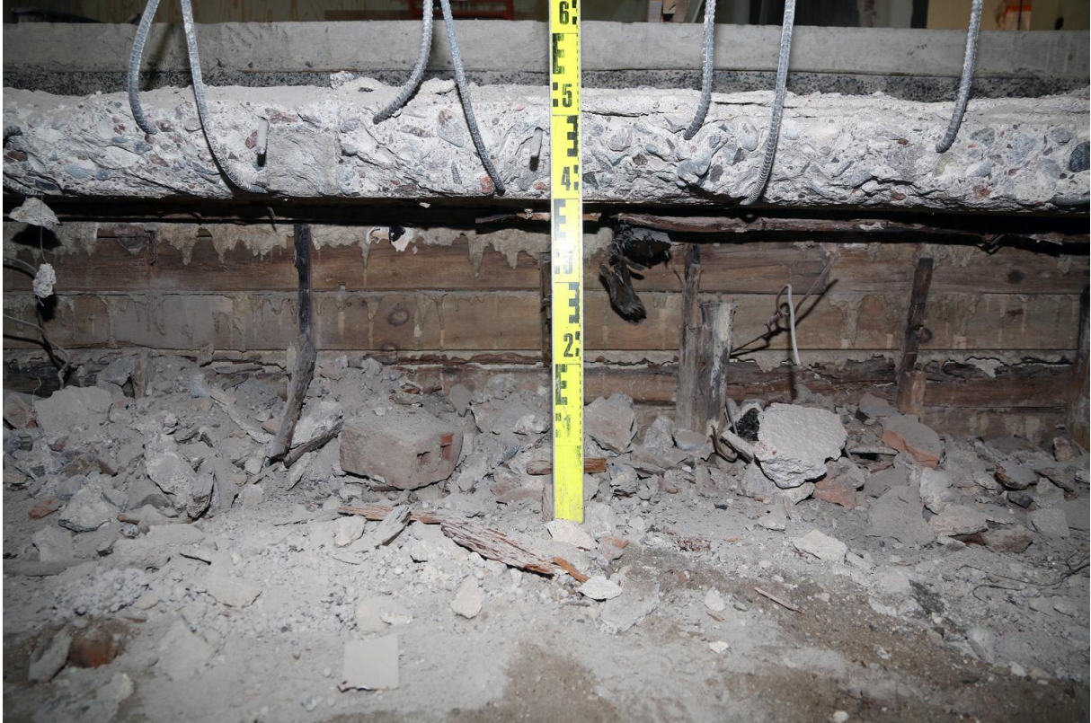
Kuva 23. Tilan eteläosan lattiaan tehdyn kaivannon eteläprofiili. Lattian alla näkyy betonivalun tukilautoitusta. Kuvaussuunta S. Kuvaaja Markku Heikkinen 16.6.2015.
