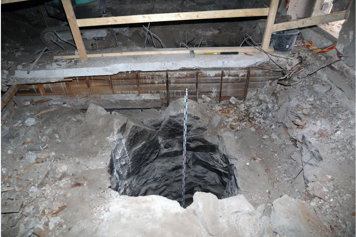
Kuva 5. Kuten edellä. Kaivolla on syvyyttä yli kaksi ja puoli metriä. Betonitaso kaivon pohjoispuolella on korkeudella 4,29 m, pintakerroksia on purettu pois. Kuvaussuunta N. Kuvaaja Markku Heikkinen 16.6.2015.
