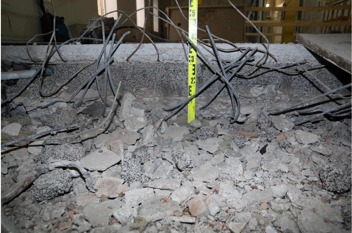
Kuva 21. Yhteensä noin 40 cm paksu eri kerroksia käsittävä betonilattia on purettu tilan pohjoisosasta. Kuva otettu etelään päin. Betonilattia on RHS:n mukaan 1960-luvulta. Kuvaussuunta S. Kuvaaja Markku Heikkinen 16.6.2015.
