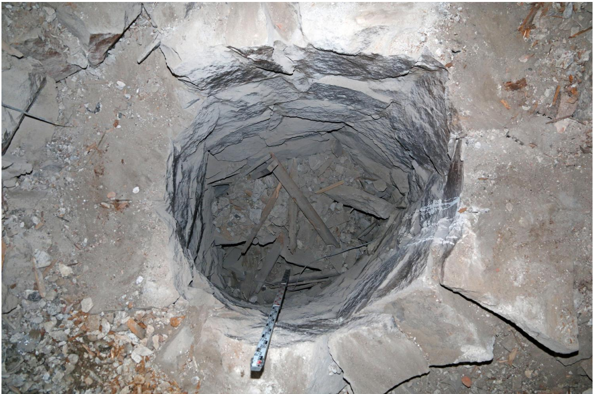
Kuva 6. Kuten edellä. Kaivo on muodoltaan soikea. Kaivon pohjalle on tipahdellut purkutavaraa aiempiin saneerauksiin liittyen sekä pieniä betonipaloja nyt puretusta lattiasta. Kuvaussuunta S. Kuvaaja Markku Heikkinen 16.6.2015.
