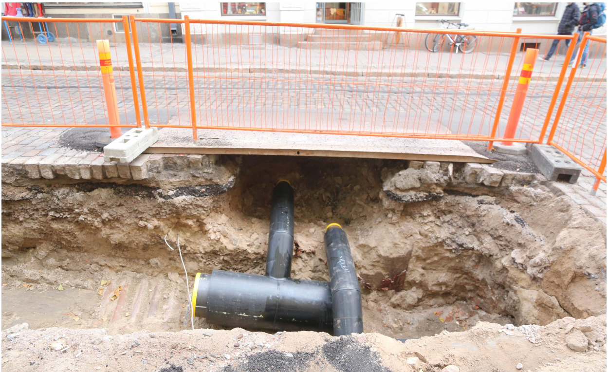
Kuva 20. Kuva samasta kohtaa kuin edellinen. Havaintopiste 6:n kohdalta alkaa itään päin suuntautuva kaivanto. Sama metallikaapeli näkyy kuvissa. Uudet putket on jo laskettu kaivantoon. Putkien alla on 11 kpl sähkökaapeleita suojakuorineen. Tästä voikin havaita, että aiemmin puhtaaksi luultu vaalea hiekka onkin täyttömaata sähkökaapeleiden päällä! Uudehkoja kaapeleita ja täyttömaita näkyvillä itäprofiilissa. Kuvaussuunta itään. Heini Hämäläinen/HKM 2.11.2015.
