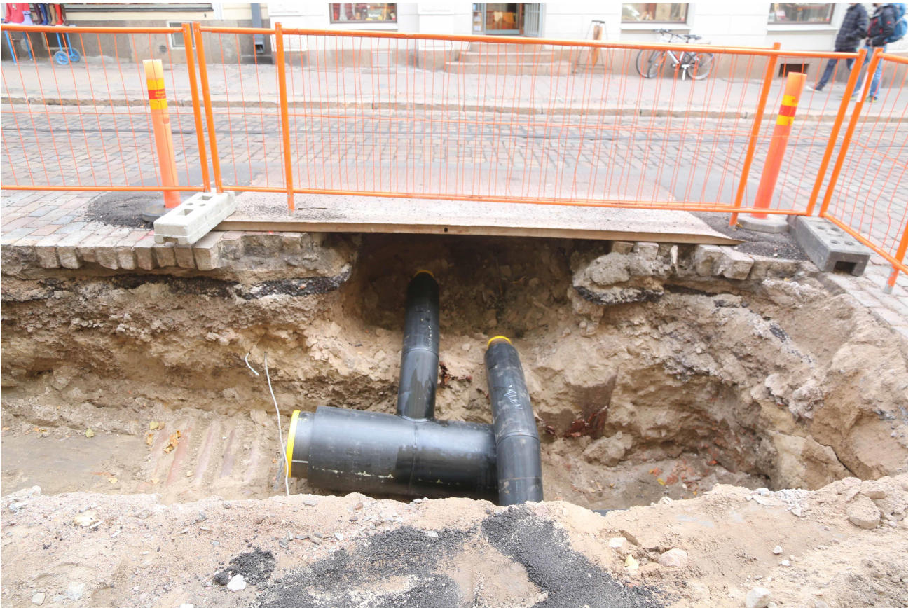
Kuva 11. Havaintopiste 6:n kohta 2.11.2015. Uudet putket on jo laskettu kaivantoon. Kaivantoa on syvennetty ja esiin on tullut kaapelimatto. Vaalea hiekka, jota aiemmin luultiin luonnolliseksi maaksi, oli kaapelimaton päällä. Uudehkoja täyttömaita näkyvillä itäprofiilissa. Kuvaussuunta itään. Heini Hämäläinen/HKM 2.11.2015.
