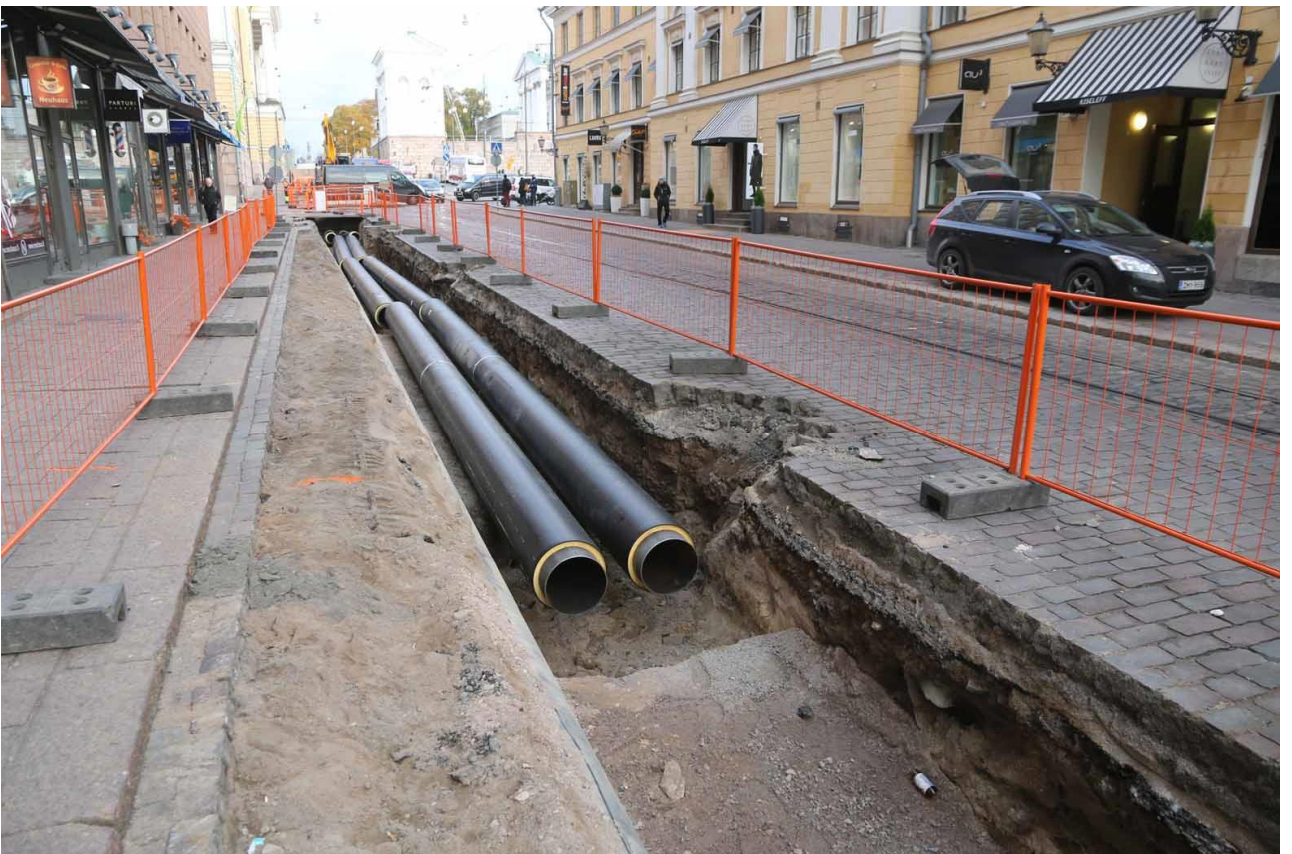
Kuva 32. Yleiskuva alueesta pohjoiseen, kun uusia putkia on laskettu kaivantoon. Kuvaussuunta pohjoiseen. Markku Heikkinen/HKM 20.10.2015.
