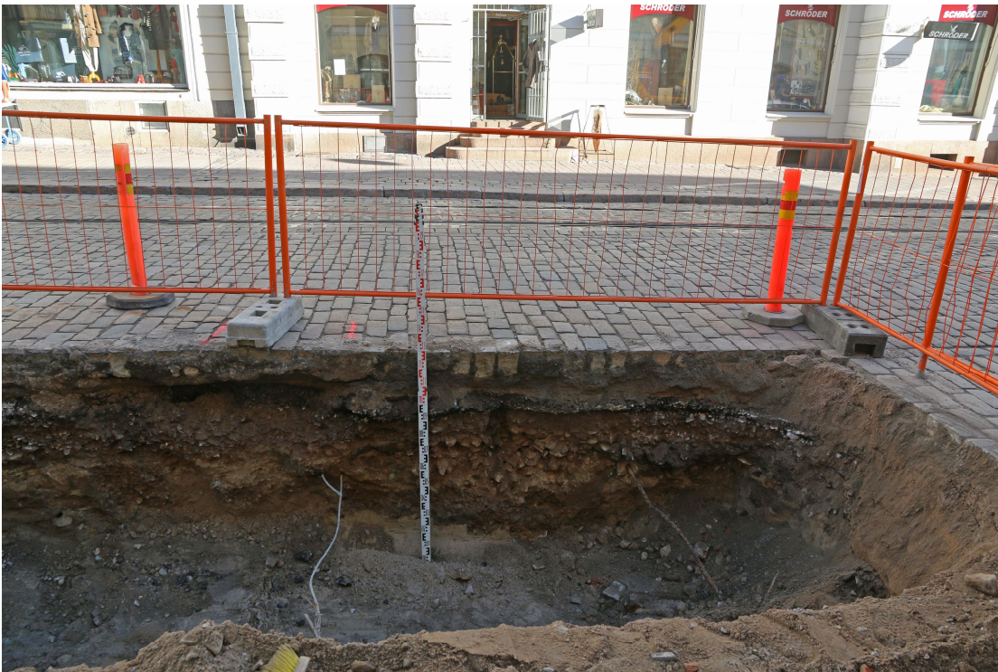
Kuva 10. Havaintopiste 6. Uudehkoja kaapeleita ja täyttömaita näkyvillä itäprofiilissa. Alinna on vaaleaa puhtaan näköistä hiekkaa. Kuvaussuunta itään. Heini Hämäläinen/HKM 14.10.2015.
