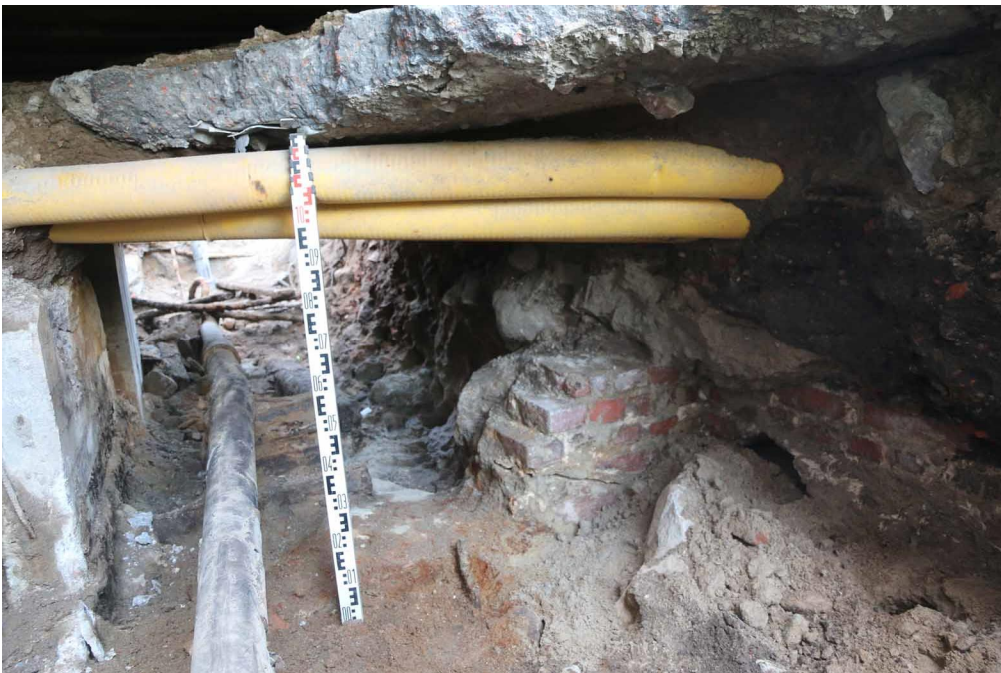
Kuva 16. Ajosillan alla oli tiilirakennetta mittaskaalan oikealla puolella, katkelma itä-länsi-suuntaista osuutta. Mittaskaalan vasemmalla puolella on kaasuputki ja kaukolämpöputkien betonikaukalo 1960-luvulta. Rakenteen päällä ja ympäristössä on lukuisia sähkö- ja telekaapeleita sekä raitiotiekiskojen betoninen perustus. Kuvaussuunta pohjoiseen. Markku Heikkinen/HKM 16.10.2015.
