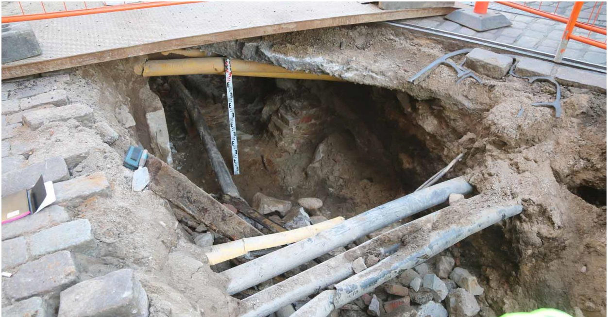
Kuva 27. Kaivannossa ajosillan alla näkyy tiilirakennetta mittaskaalan oikealla puolella, tässä sen itä-länsi-suuntaista osuutta. Mittaskaalan vasemmalla puolella on kaasuputki ja 1960-luvulla asennettujen kaukolämpöputkien betonikaukalo (joissa siis vuonna 2002 asennetut putket). Rakenteen päällä ja ympäristössä on lukuisia sähkö- ja telekaapeleita sekä raitiotiekiskojen betoninen perustus. Mustista kaapeleista etelään on täyttömaata, joten rakenne on mahdollisesti tuhoutunut tästä etelään. Kuvaussuunta pohjois-koilliseen. Markku Heikkinen/HKM 16.10.2015.
