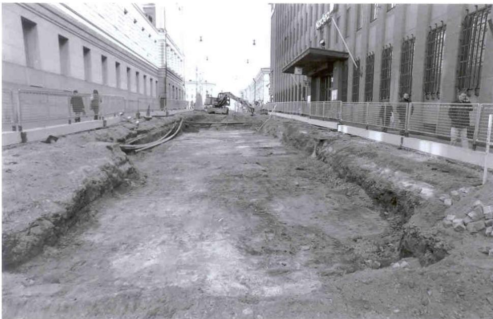
Kuva 8. Kuva vuoden 2002 valvonnasta Aleksanterinkadulla. Ajouradalta on poistettu maat raitiotiekiskojen perustuksia varten. Vasemmalla yliopiston päärakennus ja oikealla Nordea Aleksanterinkatu 30 -kohdalla. Taustalla Unioninkadun risteys. Kuvaussuunta itään. Kuva 274 285, Markku Heikkinen/HKM 19.4.2002.
