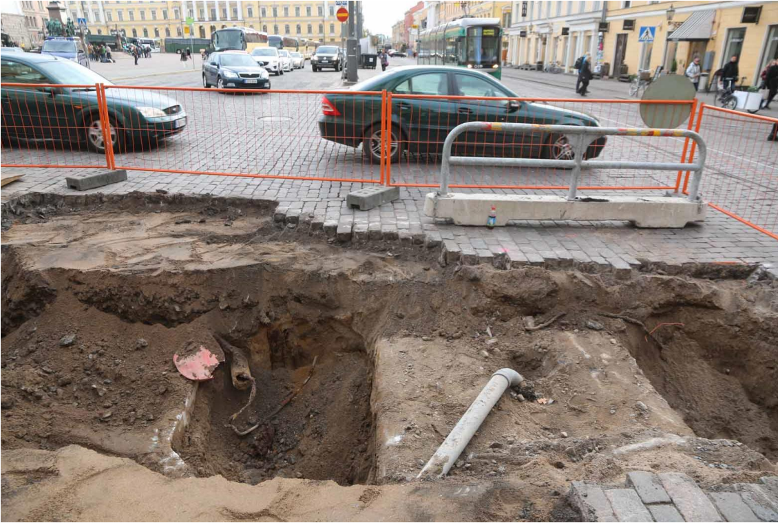
Kuva 25. Yleiskuva yliopiston vierustalalta itään. Kaivannossa on runsaasti eri-ikäisiä putkia ja johtoja. Kuvaussuunta itään. Markku Heikkinen/HKM 20.10.2015.
