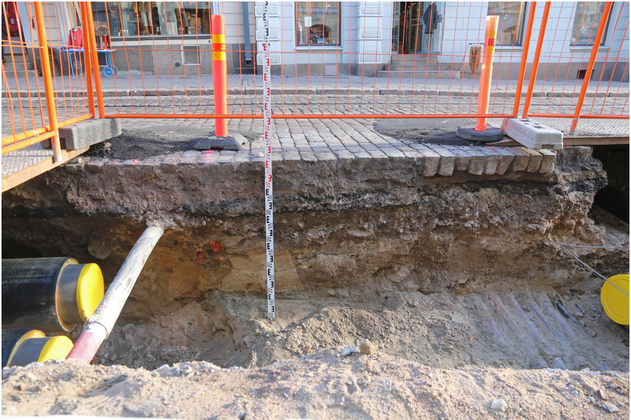
Kuva 21. Edellä kuvailtujen sähkökaapeleiden täyttömaan raja näkyy itäprofiilissa. Hieman pohjoisempänä (kuvassa vasemmalla) kulkee lähempänä maan pintaa muoviputki. Näiden väliin on jäänyt kapea suikale vaaleaa hiekkaa jonka alla on junttasavea (mittaskaalan kohta). Kuvaussuunta itään. Heini Hämäläinen/HKM 2.11.2015.
