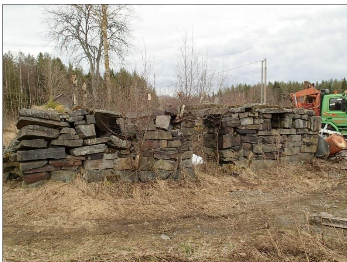
Furubackan talotontin koillislaidalla sijaitseva osittain romahtanut kivinaivetta. Koilliseen.
