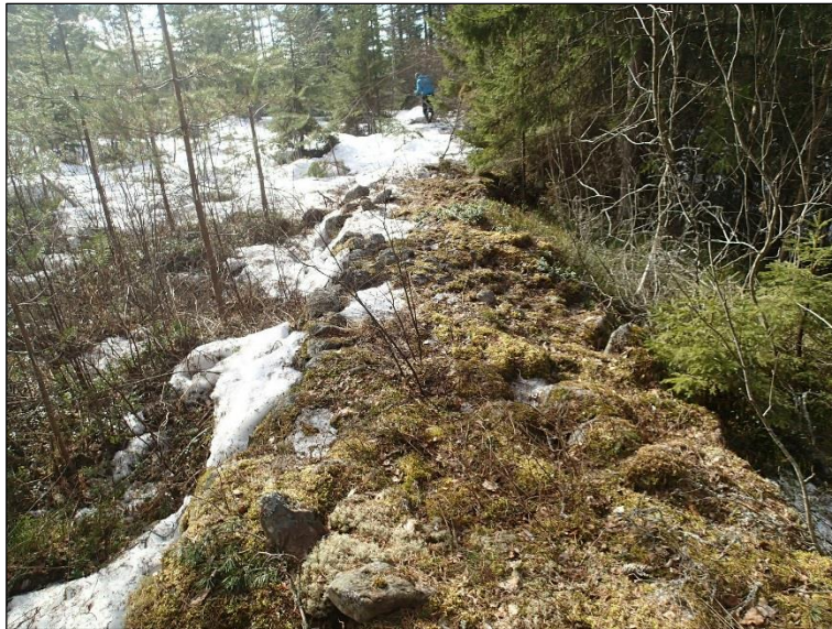
Kiviaidan eteläisempi haara, joka on osin romahtanut. Etelään.
