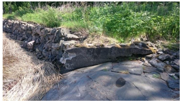
Kuva 12. Uimapaikan koillisreunan betoniaitaa. Takaseinä on sortunut. Kuvaussuunta koilliseen.
