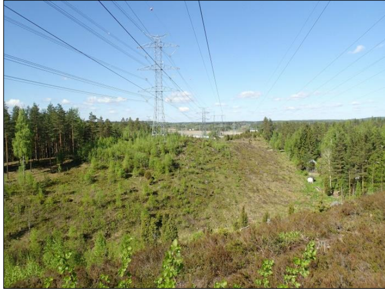
Linjan länsipää Hikiän sähköaseman itäpuolella. Länteen.
