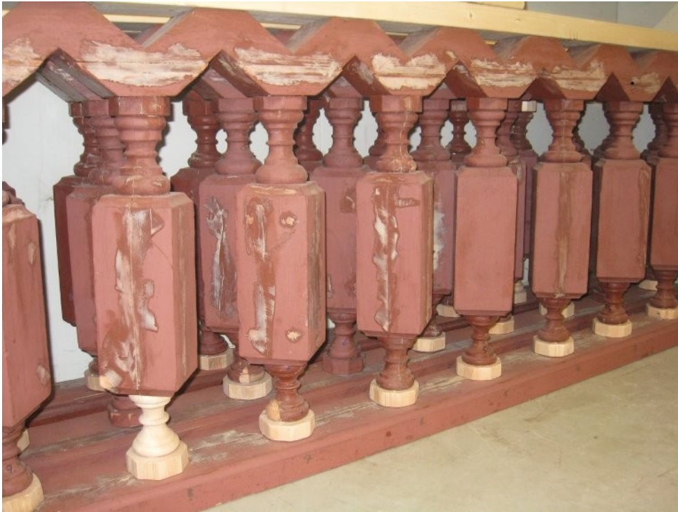
Kaideosat ennen maalinpoistoa. Puukorjauksia oli tehty lähinnä sorvattuihin muotoihin kaiteiden alaosiin.
