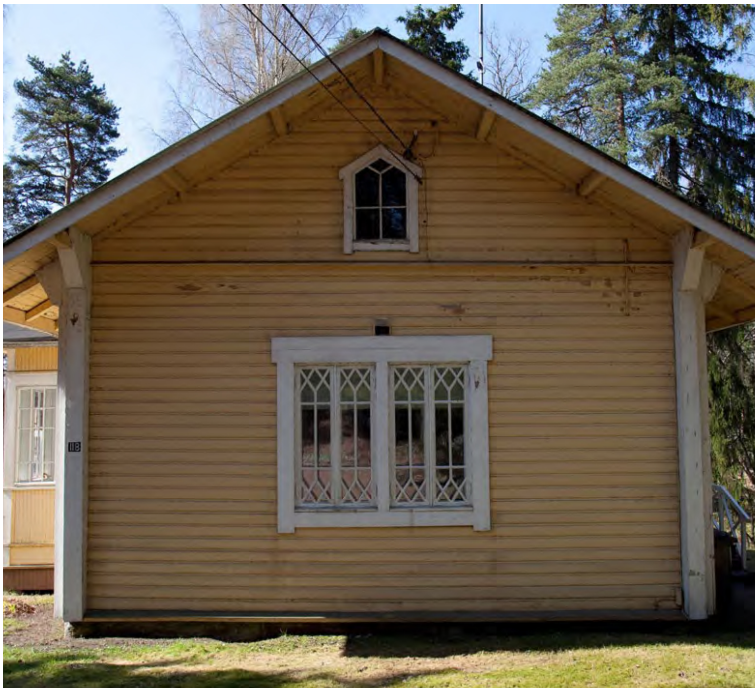
Julkisivu (Julkisivu koilliseen) Maalipinta irtoilee.
