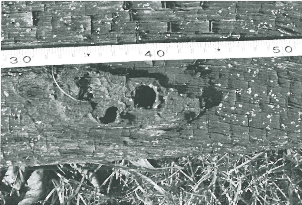
Kuva 6: Kiinnitysreikiä joissa näkyvissä korroosiota. Korroosio on peräisin mahdollisesti metallinauloista.
