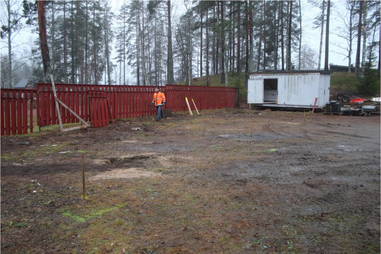
Kuva 1. Piharakennusta varten kaivettava alue rajattu vihreällä maalilla ja puukepeillä. Kuva Toni Kesti. Idästä.
