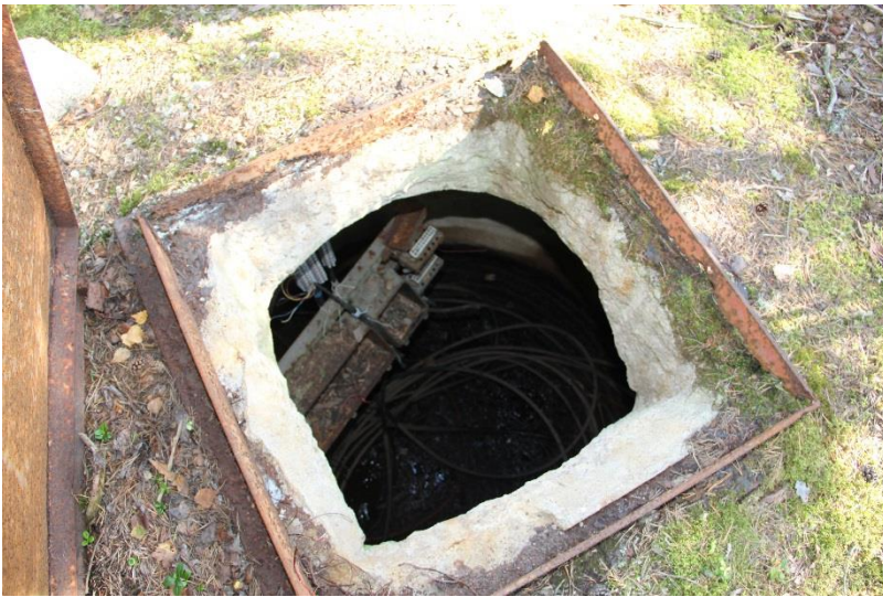
AKDG 4877:155. Itä-Villinki, kaapelikaivo. Kuvaaja: J. Lagerstedt.
