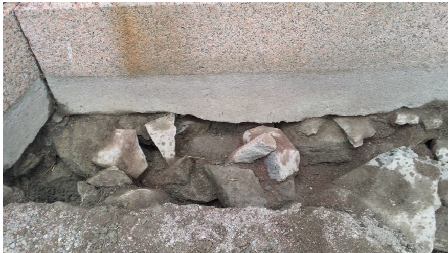
Kuva 14: MuTu116003Dg_024. Koekuoppa 3, seinän alta puuttuvat kivet. S. Kuva: J. L.
