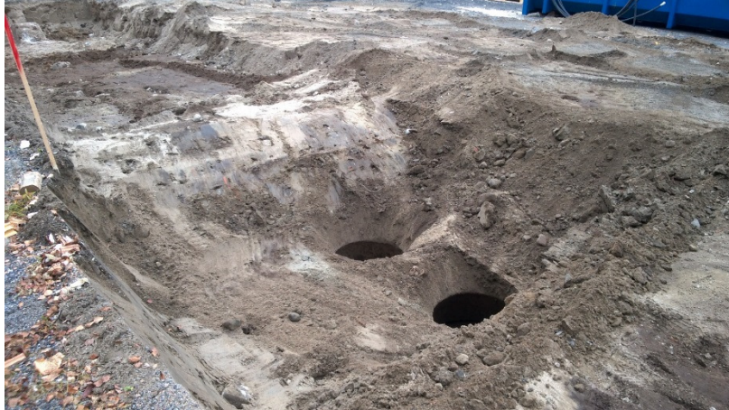
AKDG 4879: 70. L8 viemärikaivot alueen luoteisreunalla. T. Taipaleenmäki
