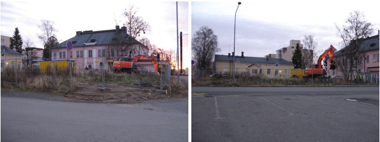
Yleiskuvia tontista ennen vuoden 2015 perustuskaivannon kaivun aloittamista. Vasemmanpuoleinen on otettu Eliaksenkadun ja Välikadun risteyksestä, oikeanpuoleinen Välikadun poikki, kadun toisella puolella olleelta parkkialueelta. Keltainen puurakennus on Avelan talo, ja vaaleanpunainen kivitalo on vanha Yhdyspankin talo, jossa nykyisin toimii Handelsbanken. Kuvat vuoden 2015 tutkimusraportista, AKDG 4495:1 ja 2. Kuvaaja T. Taipaleenmäki.
