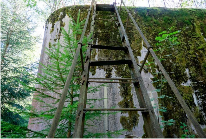
AKDG 4500:4. Isosaari 1. Valonheittinaseman katolle johtavat tikapuut ovat rikki. Kuva pohjoisesta. Kuvaaja: V. Laulumaa.
