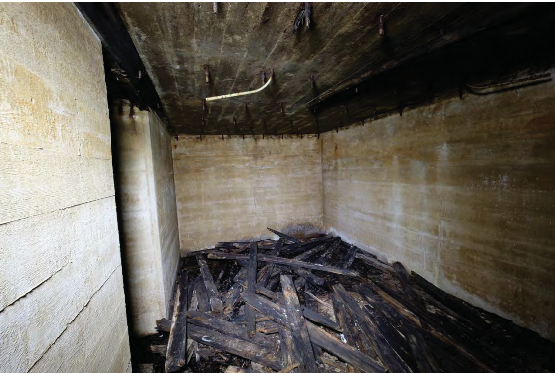
Kuva 8. Ensimmäinen huonetila sisään tullessa. Katon lautaverhoilu on lahonnut ja pudonnut lattialle. (AKDG4603:8)
