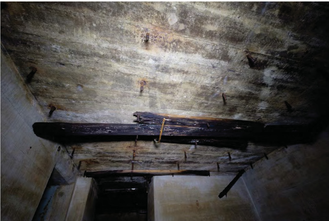
Kuva 12. Kuva korsun katosta, jossa vielä roikkuu pari lahonnutta lautaa. (AKDG4603:12)
