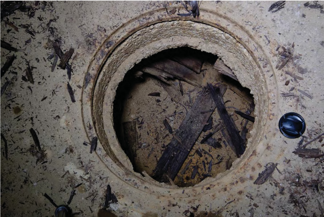
Kuva 21. Sulkuhuoneen kokoajakaivo. (AKDG4603:21)
