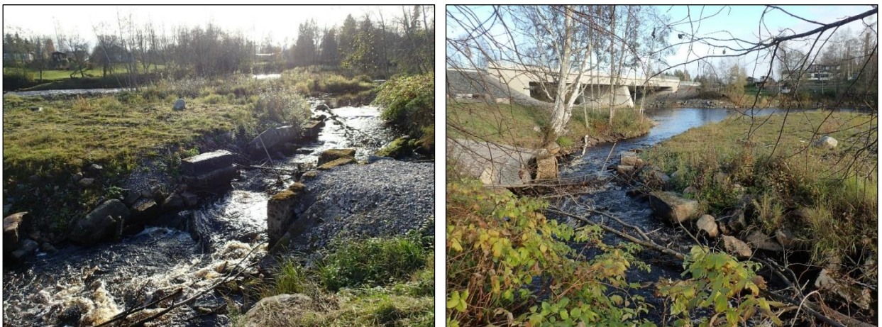
Vasen: Raasakankosken kivi- ja betonirakenteita. Eteläkaakkoon. Oikea: Raasakankosken betoni- ja kivirakenteita. Koilliseen.
