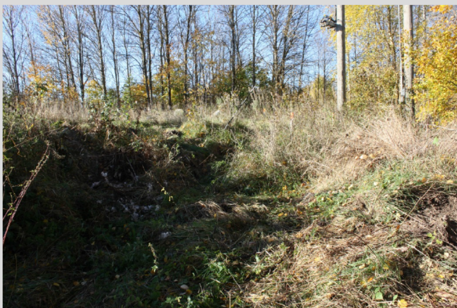
AKDG 4876:5. Saaren kartano. Maakaapelilinjan kohtaa pylväsmuuntajan itäpuolella. Linja leikkaa täyttömaakumpareen rinnettä. Idästä. Kuvaaja: Johanna Seppä.
