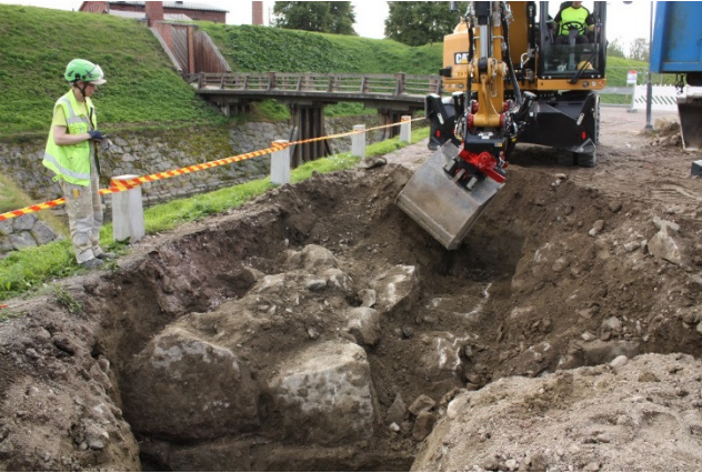
AKDG4721:79 Raveliin oikean sivun eskarppimuurin ensimmäistä kivikerrosta on purettu asennettavan sadevesiputken kohdalta. N-S. Kuva Katja Vuoristo.
