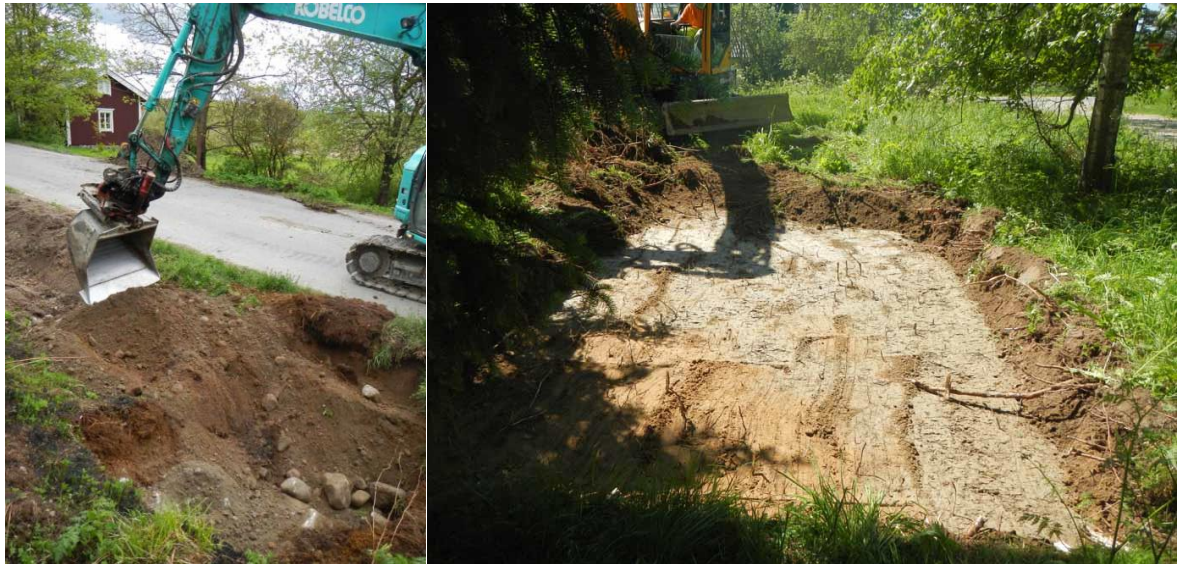
Kuvat 7 ja 8. Vasemmalla (kuva 7) Lunkaantien varteen kaivettu suuntaporan ulostuloaukko, kuvattu pohjoisesta. Oikealla (kuva 8) Levotien varteen kaivettu muuntajanpaikka, kuvattu koillisesta. (Kuvat: Tammela Lunkaa 2016:5 ja 6)
