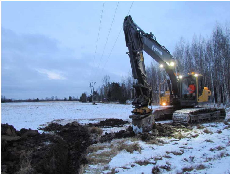
Kuva 4. Kaivuri kaivaa maakaapelilinjausta Herralan kylätontin lounaispuolella. (Kuva: Lempäälä Herrala ja Hääkivi I 2016: 3)
