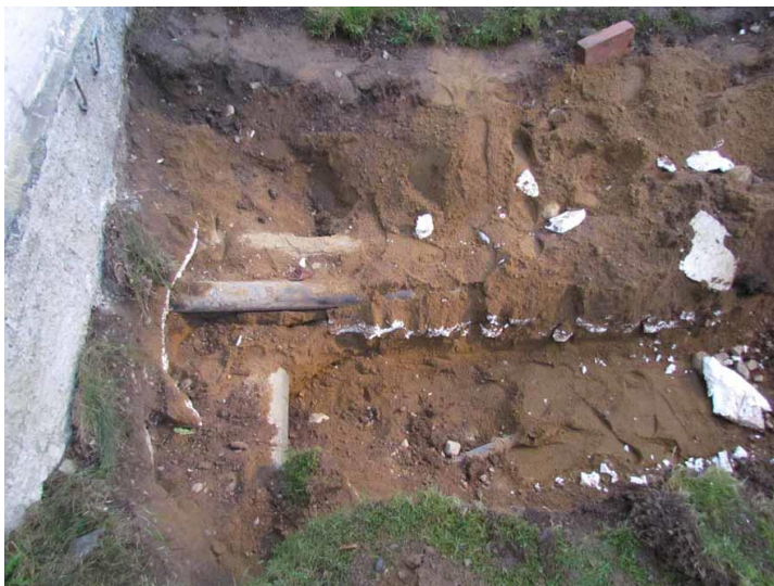
Kuva 12. Vanhoja kaapelilinoja ja vanha aluelämpö- ja vesiputkipatteri työsiirtolarakennuksen pohjoisseinän keskellä, uusien putkien sisäänviennin kohdalla. Kuvattu idästä. (Kuva: HML Ojoinen 2016: 8)
