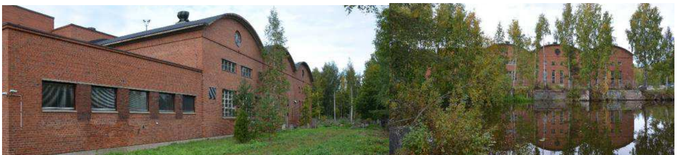
Kuvat: Kuorimon betoniholvien kattamaa itäjulkisivua, vanhin osa (1933) näkyy kuvien oikeassa reunassa, keskimäinen osa valmistui 1941 ja vasemmanpuoleinen sen matala siipiosa 1959. Vanhimpaan osaan liittyi pohjoispuolella alun perin matala siipiosa, joka on purettu myöhemmin. Kasvillisuutta karsimalla kuorimon pääjulkisivu näkyisi paremmin Nokianvirran maisemassa.
